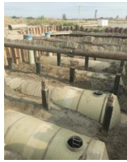
Рисунок 4 – Реализация инновационной подземной системы водоотводных ливневых колодцев
